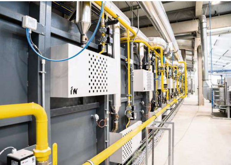
Detalhe de sistema de combustão de forno túnel.
