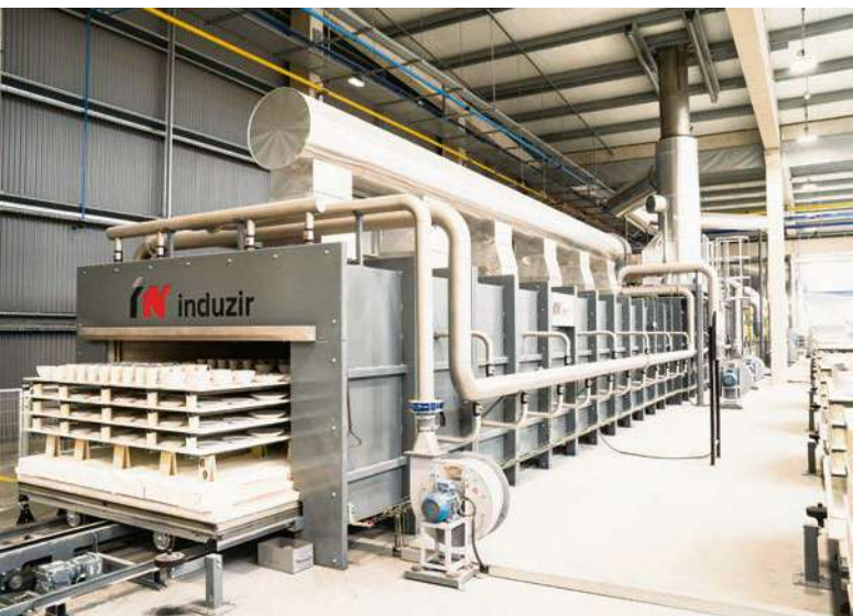
Forno Túnel industrial.
